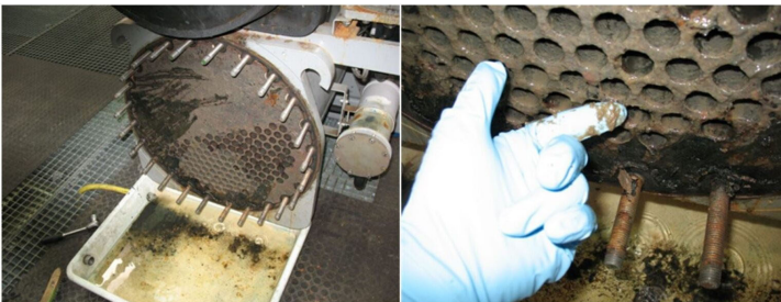
Biofilmbildung an einem Rohrbundlewärmeübertrager mit Detailaufnahme (rechts) (Abb. © Guido Hilden/VDI Kommentar)
